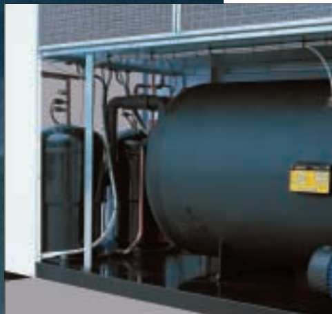
depósito de agua integrado
